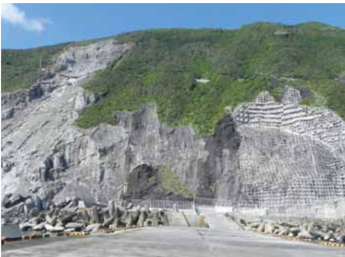
三宝港背後の斜面崩壊
